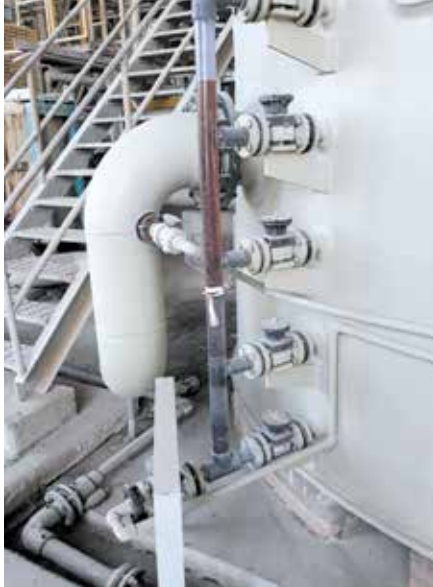
Biochemische Anlage, Lagerung und Dosierung von Phosphorsäure
