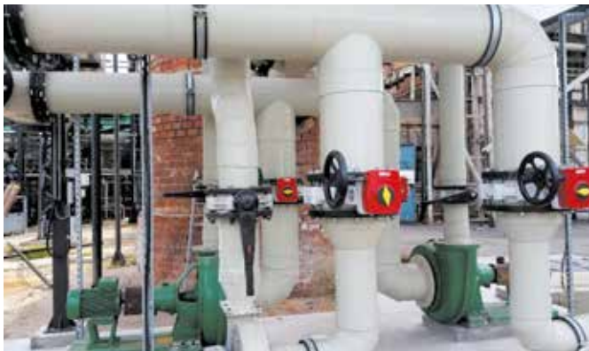
Anlage zur Herstellung von Natriumhypochlorit
