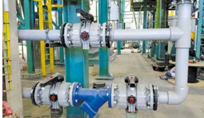
Anlage zur Herstellung von Phosphat, Dosierung von Phosphorsäure und Schwefelsäure
